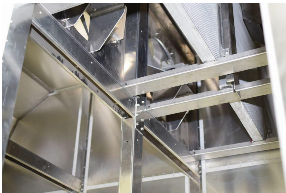
Figura 27 - Radiatoare si ventilatoare uscator
