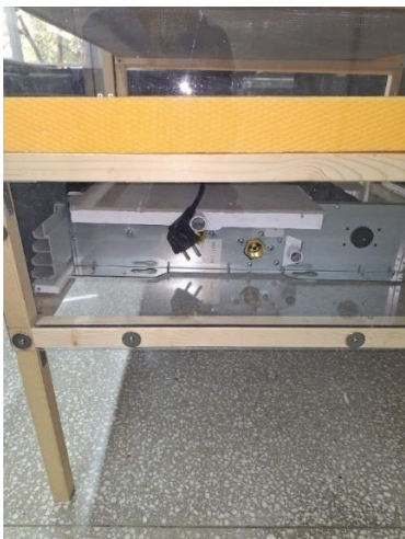
Ventiloconvector amplasat pe fundul camerei uniformizare aer cald
