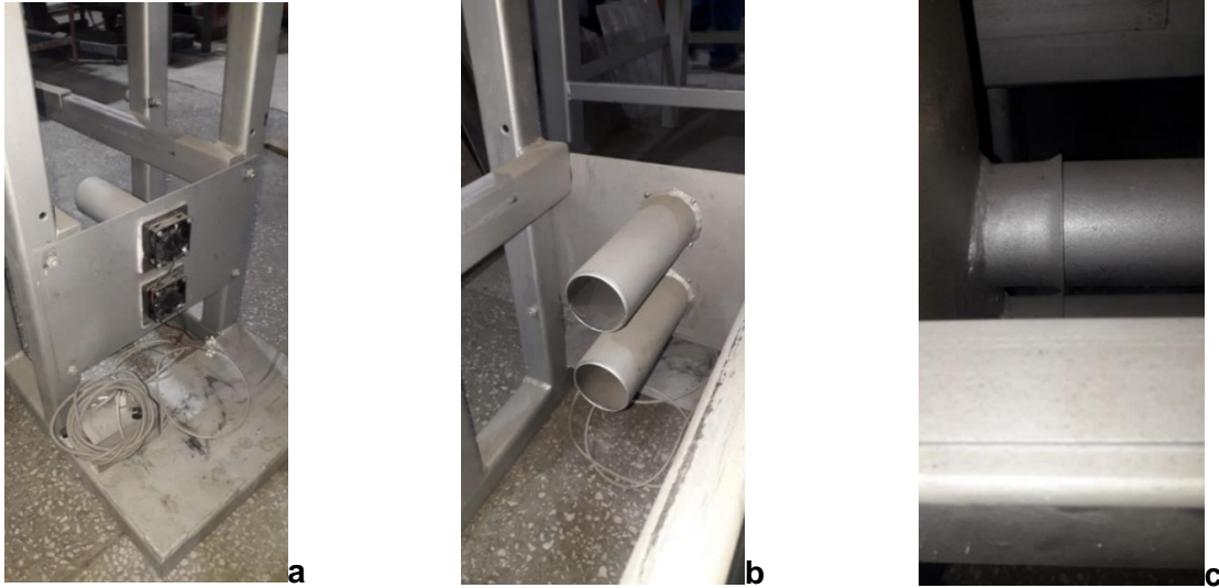
Fig. 12 a, b Tevile de aer de gazeificare / ardere singaz sudate pe placa ansamblului alimentare aer, echipate cu ventilatoare -realizare fizica; c Modul de cuplare a tronsoanelor tevilor de aer
